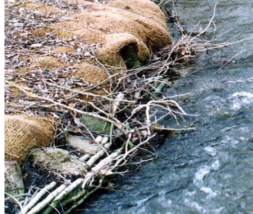
Abb.5: Uferschutz durch Faschinen und Längsholz mit Fischnischen sowie Erosionsschutz der Böschung durch bepflanzt Kokosnetz.
