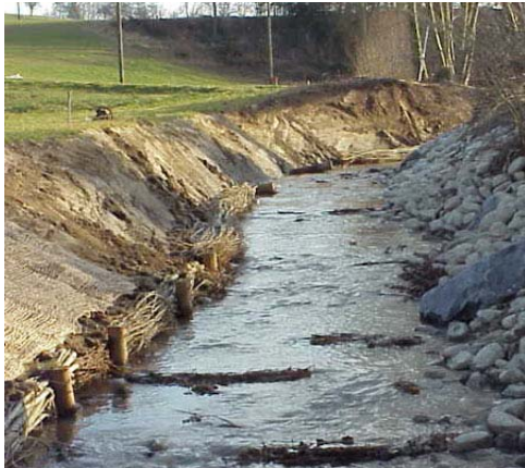
Abb.4: Uferschutz mit Faschinen und Böschungssicherung durch Jutenetze (links) und Blocksteinwurf (rechts). Flechtwerkbühnen im Bachbett zur Verlagerung des Stromstriches.
